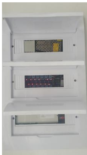
Obr. 3 Riadiaca jednotka v elektrickej rozvodovej skrini
