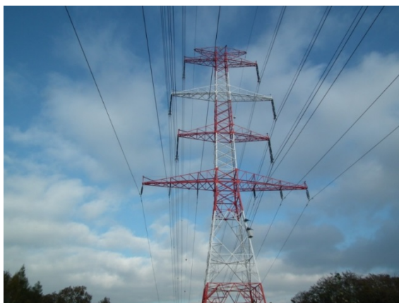
Obr. 1 Pohľad na viacsystémové vedenie
